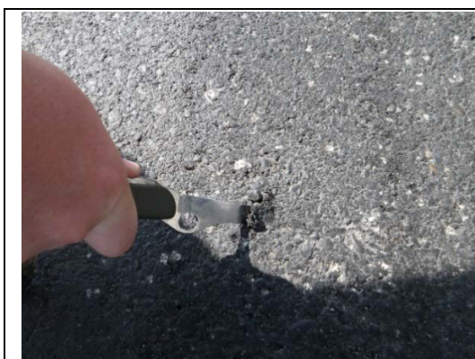
Abb. 32: Ungeeignete Asphalt-schicht Quelle: Eigenes Bildmaterial
