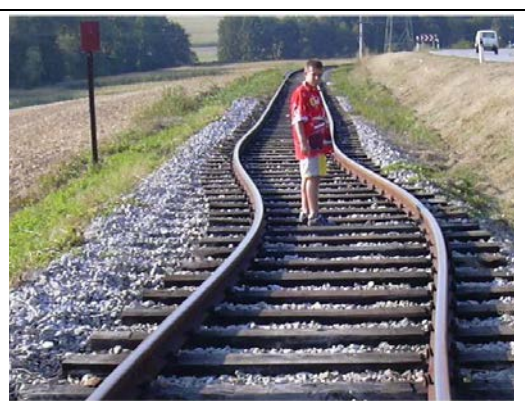
Abb. 33: Gleisverwerfungen infolge Temperaturbelastungen Quelle: Fürmetz 2009, S. 6
