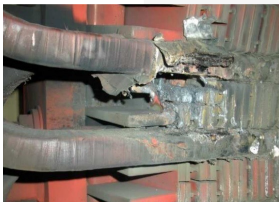
Abb. 2: Durchschlag der Hauptisolierung im Abtreppungsbereich
