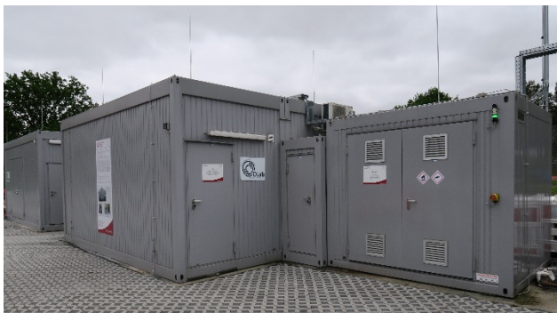
Abbildung 2: Die Laborcontainer der Brennstoffzellen- und Methanisierungslabore auf dem IKC
