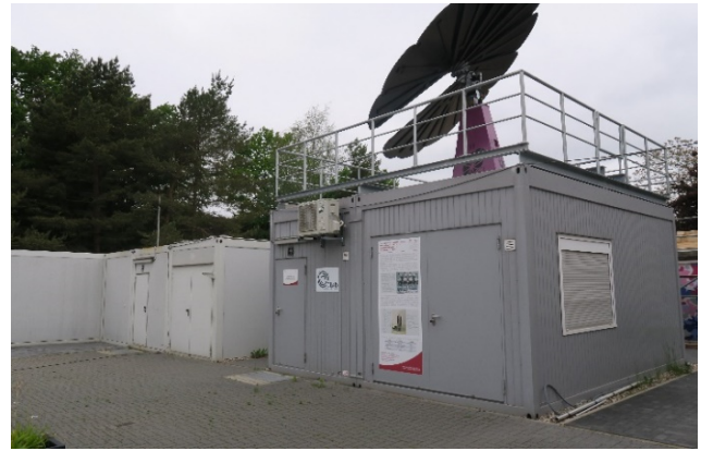
Abbildung 3: Mittelspannungslabor, Hocheffizienz-Solaranlage mit Sonnennachführung, Batteriespeichercontainer auf dem IKC
